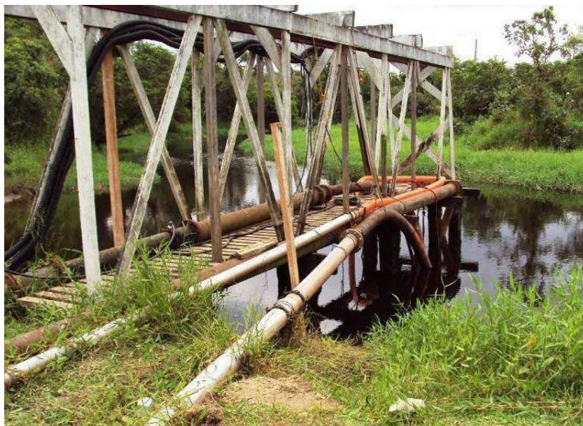
Figura 28: Captação ETA Principal
