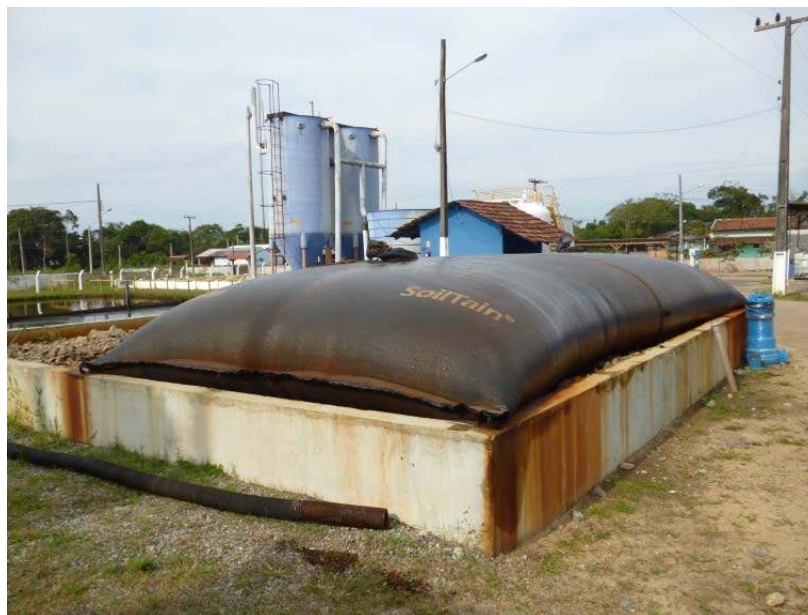
Figura 53: Sistema de Bag para Desidratação do Lodo das Lagoas de Decantação da ETA Principal
