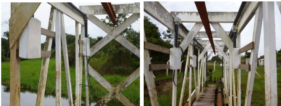
Figura 30: Melhorias nas Instalações de Captação Principal
