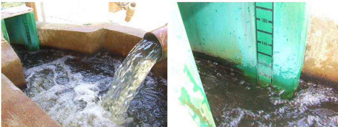
Figura 66: Chegada da Água Bruta e Calha Parshall – ETA Secundária
