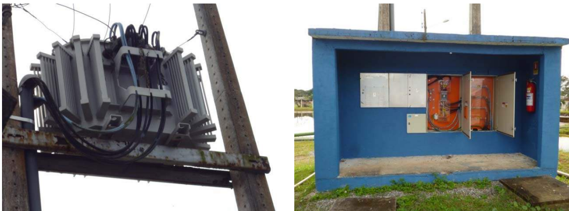
Figura 60: Vista Geral do Novo Transformador e Painéis de Entrada de Energia Elétrica da ETA Principal
