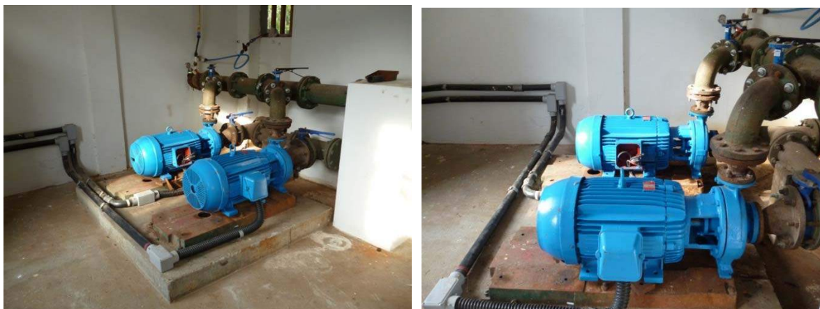
Figura 74: Conjuntos Motobombas da ETA Secundária
