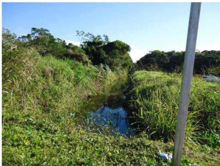
Figura 155: Assoreamento da Macro drenagem com Valas Superficiais
