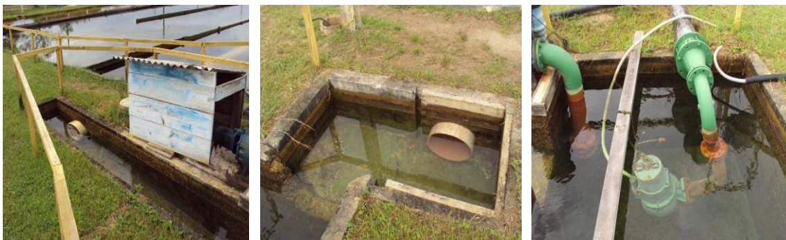
Figura 43: Estação de Recalque de Água Decantada – ERAD
