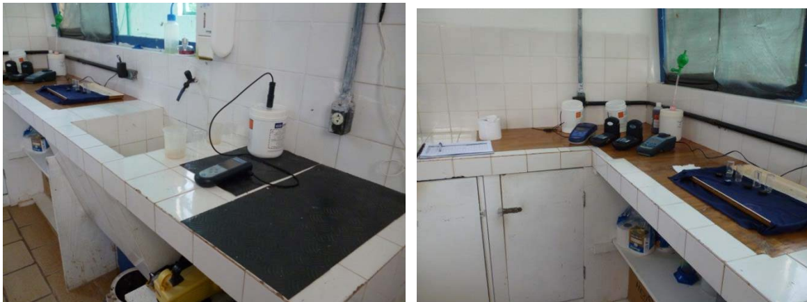
Figura 72: Instrumentos Dosadores Utilizados na Operação da ETA Secundária
