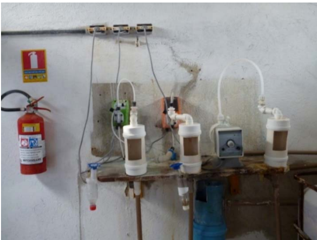
Figura 57: Instrumentos Dosadores da ETA Principal
