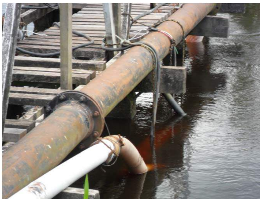
Figura 35: Adutora de Água Bruta – ETA Principal
