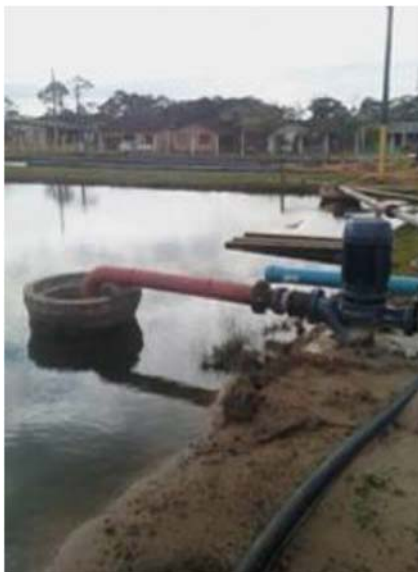
Figura 45: Detalhe da Captação da Água Clarificada na Lagoa de Decantação
