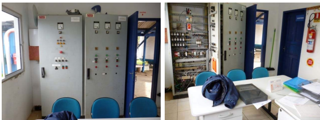
Figura 59: Vista Geral dos Novos Painéis de Comando da ETA Principal
