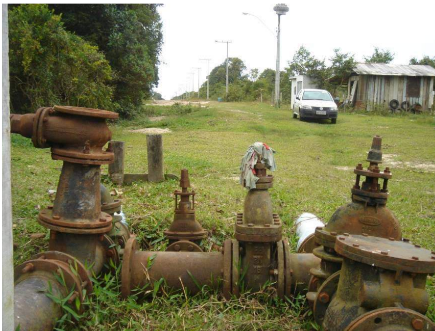
Figura 34: Adutoras da ETA Principal – 2 Linhas de DN=200 mm em Ferro Fundido
