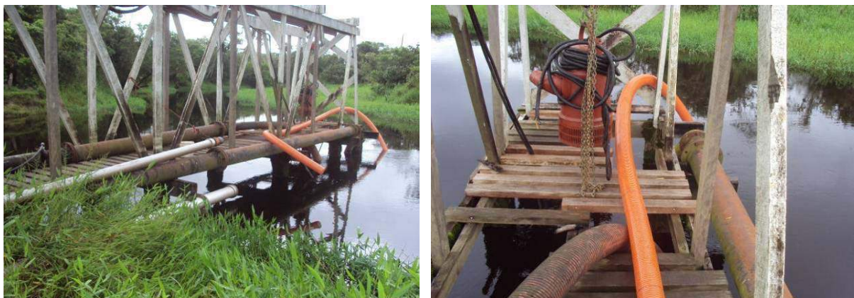
Figura 79: Estrutura de Acesso às Bombas de Recalque de Água Bruta
