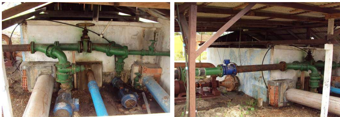
Figura 51: Estação de Recalque de Água Tratada
