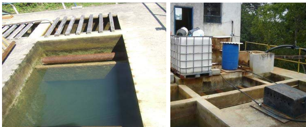
Figura 69: Filtração – ETA Secundária
