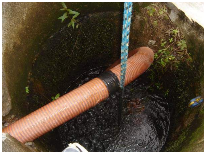
Figura 32: Captação de Água Bruta ETA Secundária
