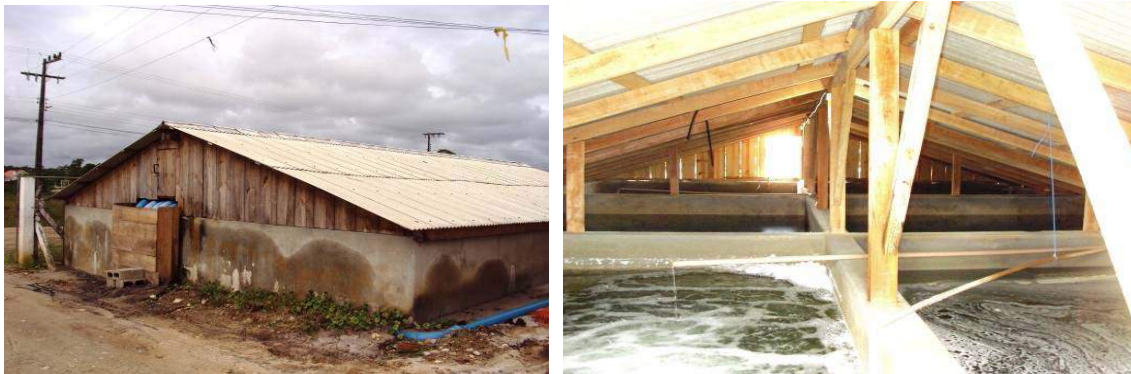
Figura 50: Tanque de Contato
