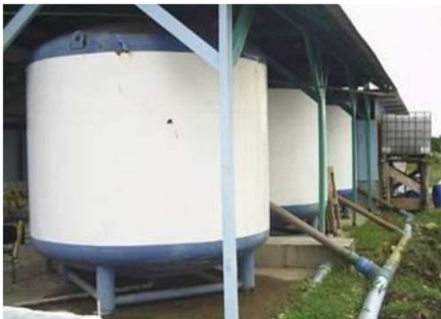
Figura 47: Vista dos Filtros Russo
