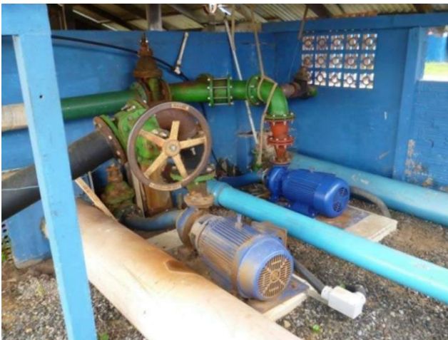
Figura 56: Conjuntos Motobombas Existentes na ETA Principal
