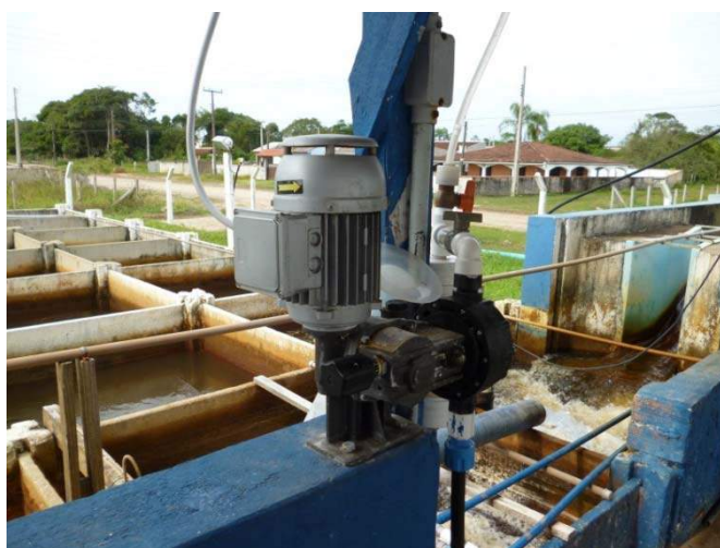
Figura 62: Bombas Dosadoras da ETA Principal
