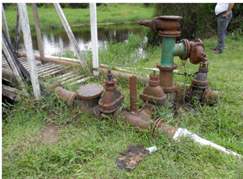
Figura 33: Adutora de Água Bruta – ETA Principal
